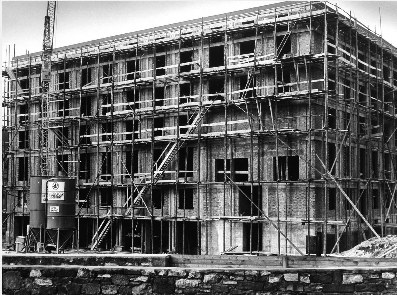
Nach den Zerstörungen des zweiten Weltkriegs benötigte man für die Regierung von Unterfranken ein neues Gebäude – hier zu sehen ist der Bau des heutigen Hauptgebäudes.
